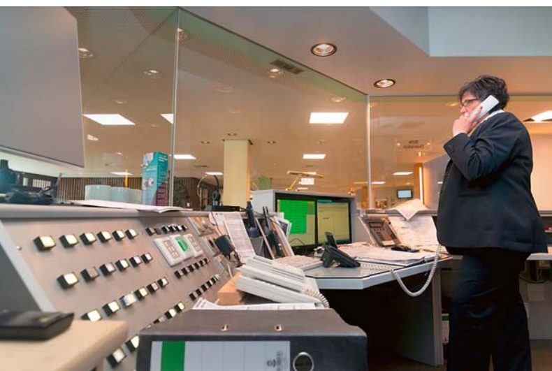
Blick in die Leitzentrale mit Kommunikations- und Alarmerfassung
